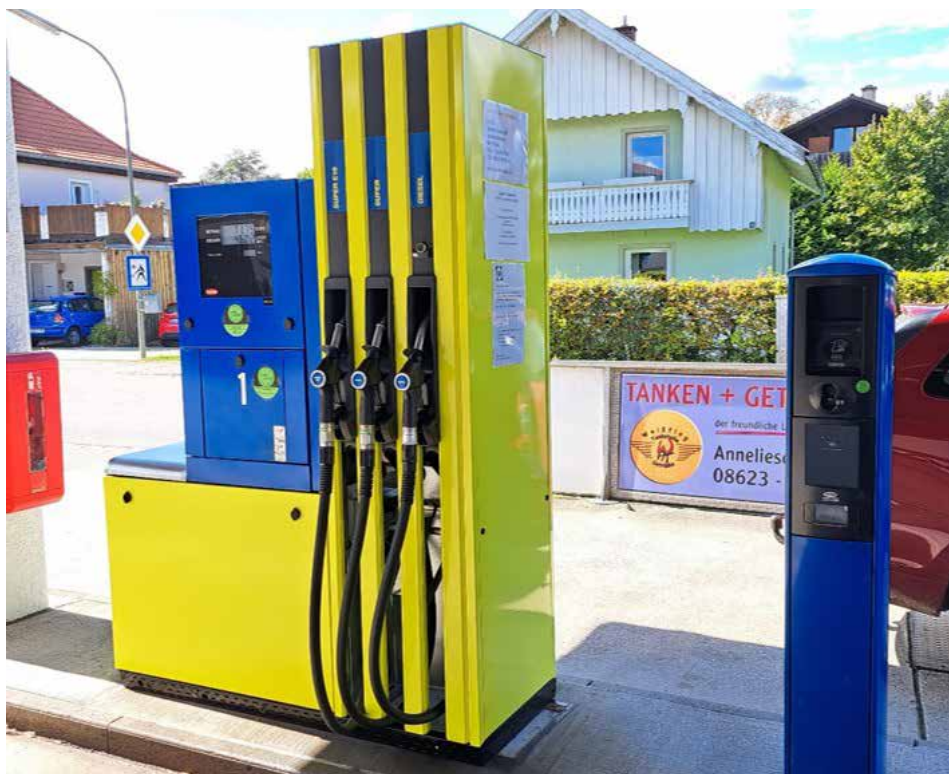
Die neuen Tanksäulen
